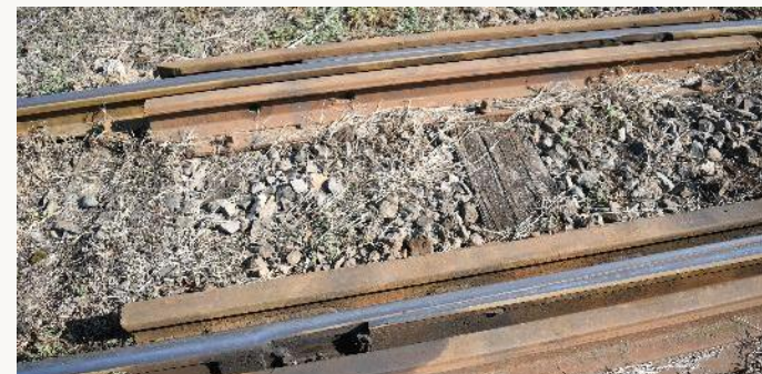
Traversă lemn degradat
