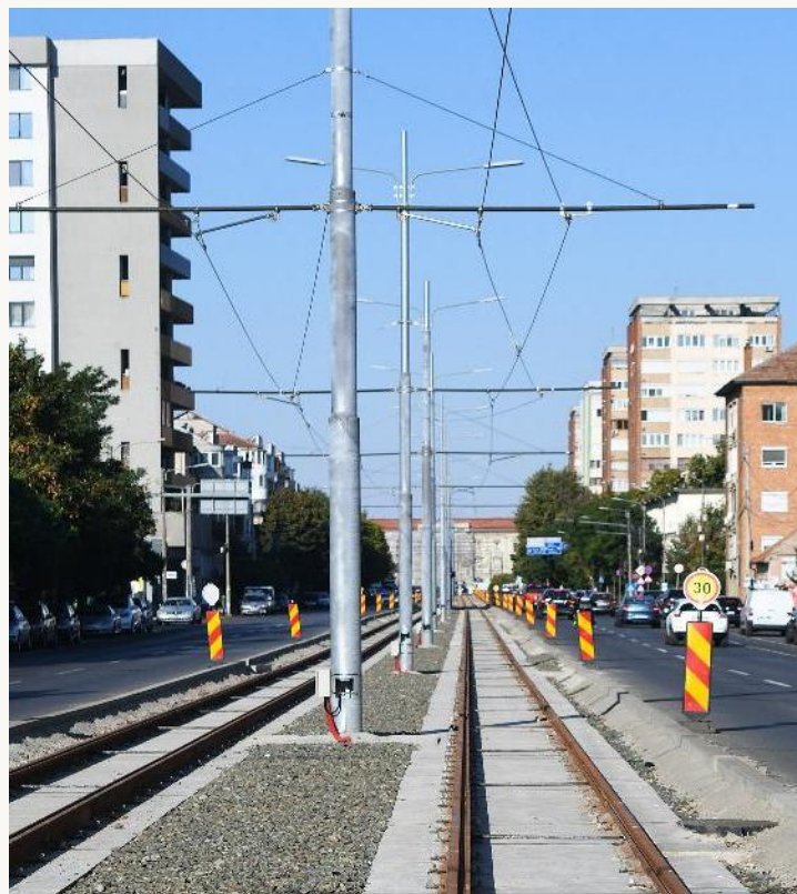
Rețeaua de contact – stâlpi metalici
