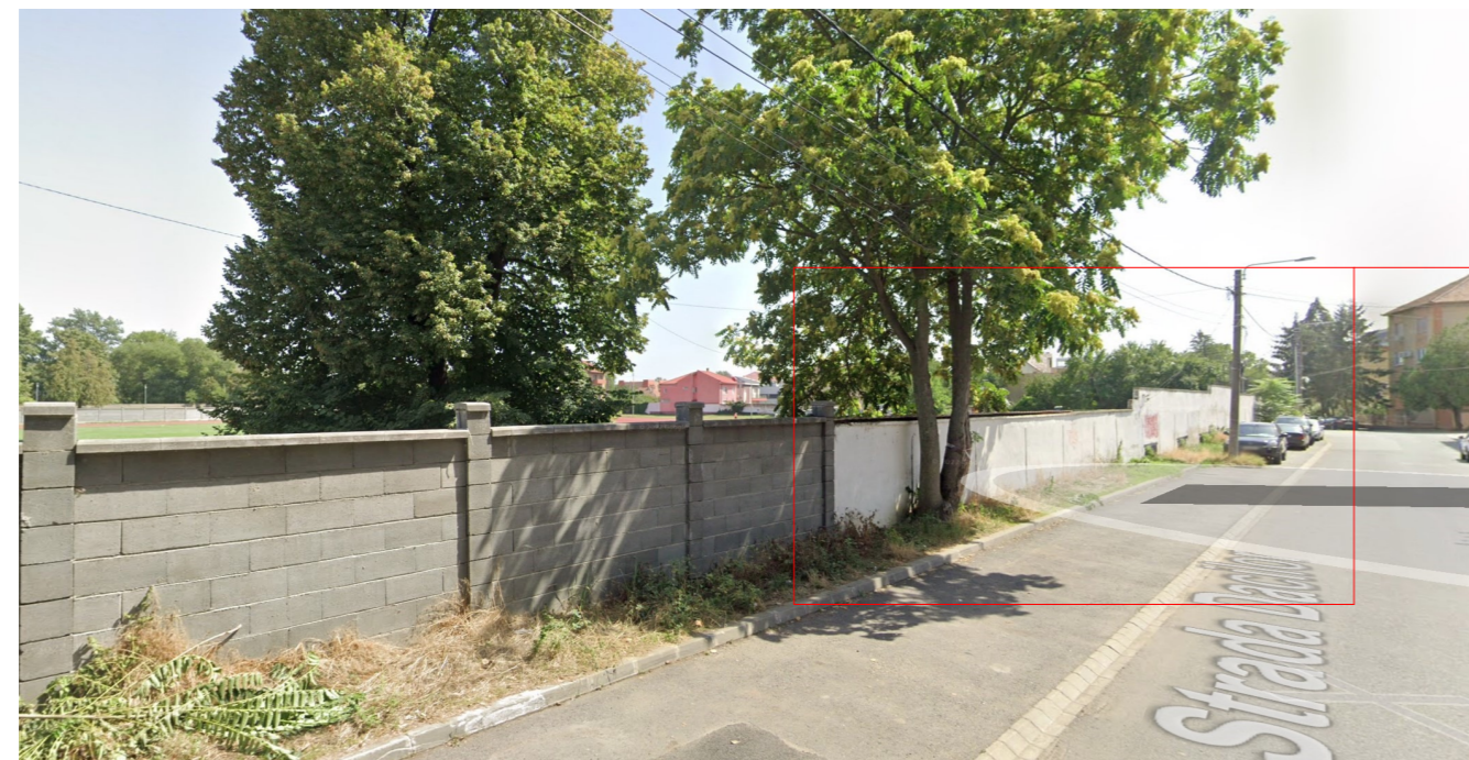
GARD PROPUS SPRE DEMOLARE SI RECONSTRUIRE
